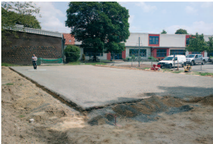
Neuaufbau Bolzplatz, Bauherr: Stadt Wunstorf, Oststadtschule, Splittaufbau mit fertig gestelltem Feinplanum, Bolzplatz nach Teppichvliesmontage.
